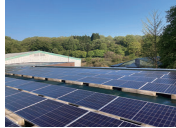
校舎の屋上に設置した太陽光パネル
